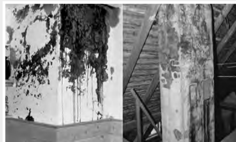
Versottung - hier droht Gefahr für die Hausbewohner
